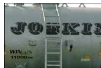
Upper manhole (Ø 600mm)
